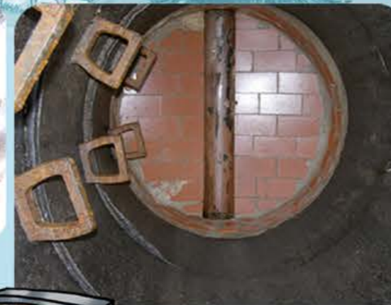
Schacht ist in Ordnung. Dichtheitsprüfung bestanden
