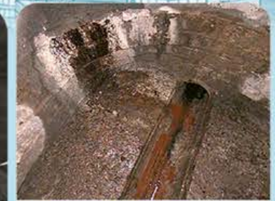
Eindringendes Grundwasser Dichtheitsprüfung nicht bestanden
