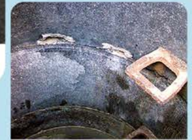
Schachtwandung defekt - Ausbruch Dichtheitsprüfung nicht bestanden
