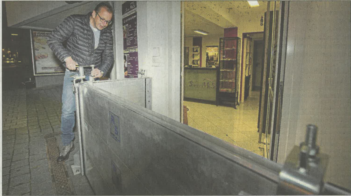
Andreas Schubert kann die mobile Spundwand innerhalb weniger Minuten aufbauen. Doch sie ist nicht die einzige Schutzmaßnahme. Fotos: A. Becher
